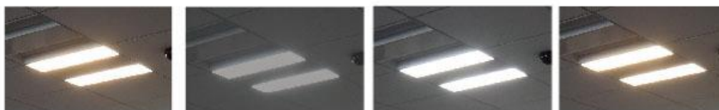
調光・調色型 LED 照明器具 (20 台)
